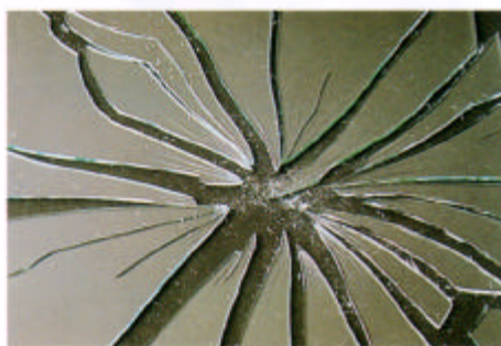
普通の板ガラスの破損状況
